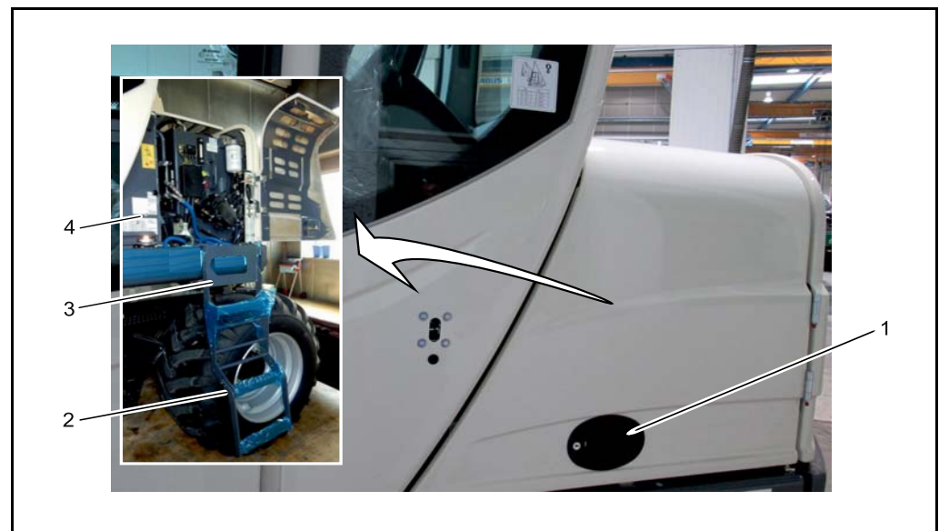
Fig. 6-13 Trappe de maintenance
